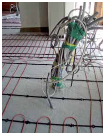
Celková plocha podlahového vykurovania je 4 032 m 2 , inštalovaný výkon je 448 069 W
